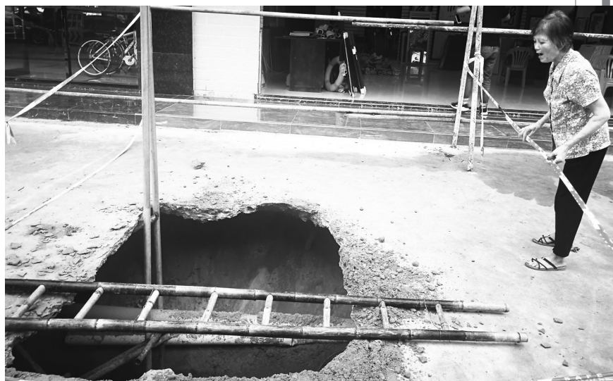
被掏空的地下深坑。
