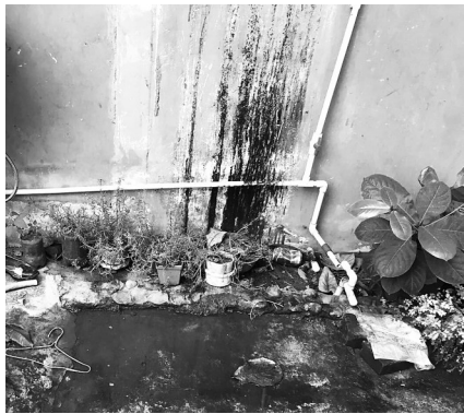
白色的小口径管道为饭店私接的水管。
