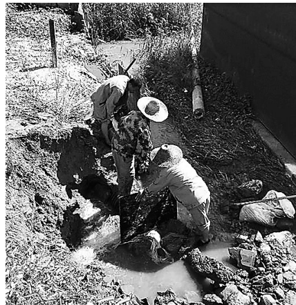
桑德公司工作人员对破裂管道进行封堵。
