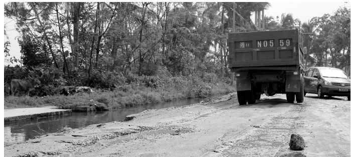
道路泥泞坑洼不平,村民无奈搬来石块让车辆减速。南国都市报 王渝 摄
