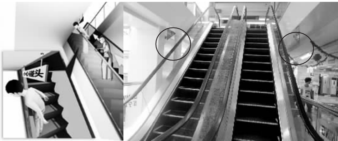
用封闭防护挡板将容易发生危险的“三角区”(画圈处)封死,可以防止乘客因将头、手等伸出扶手外侧而发生伤害;然而,海口几乎见不到有自动扶梯安装封闭挡板。(左图为资料图,右图由本报记者何慧蓉摄)
