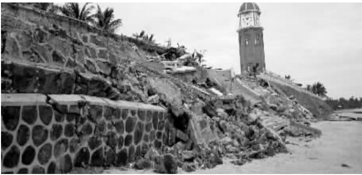
观海台护堤坍塌面积有扩大趋势
