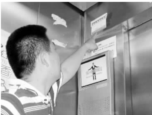
该电梯安全检验合格证已过期
